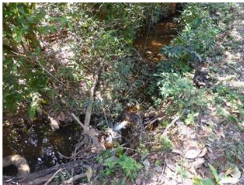
Figura 7.9 – Tomada d'água com crivo precário, adutora de água bruta e córrego, respectivamente.
