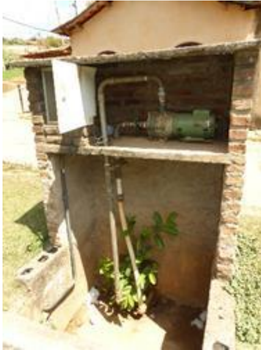
Figura 7.16 – Booster interligado na rede de distribuição.
