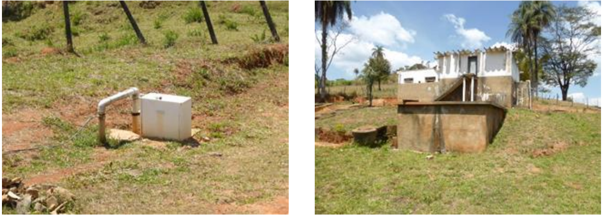
Figura 7.12 – Cloração água e ETA – Morro Vermelho, respectivamente.
