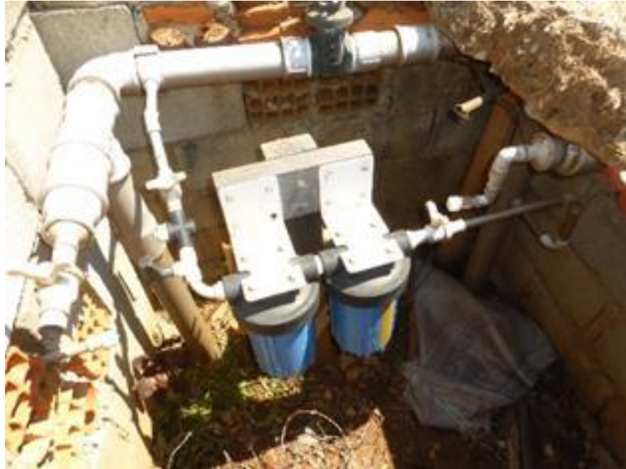
Figura 7.15 – Caixa de chegada da captação Secundária – filtros não funcionam.
