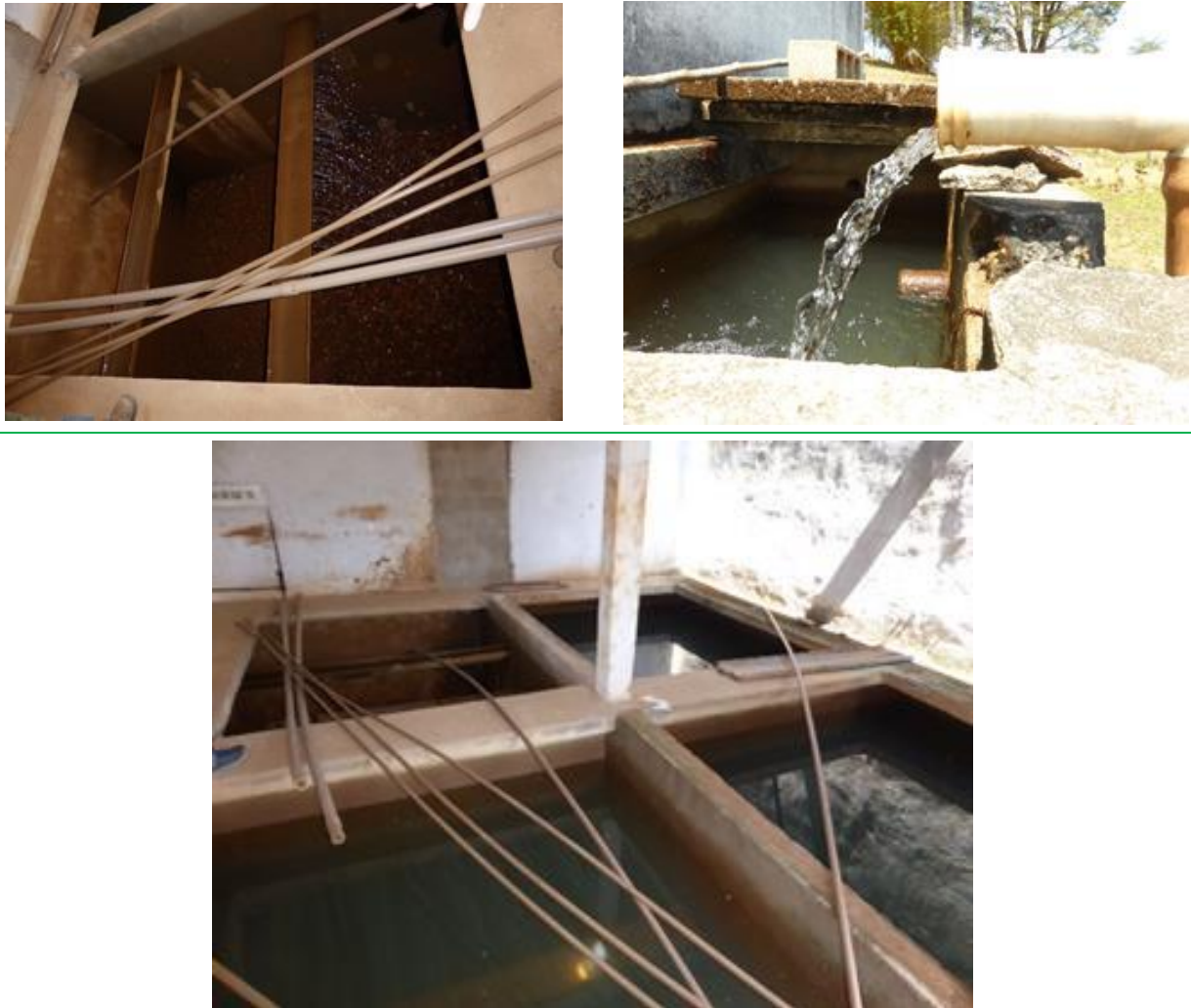
Figura 7.13 – Filtro Lento precário (pré-filtro), água afluyente na ETA e Reservatórios à direita e filtros lentos precários à esquerda (pré-filtro), respectivamente.
