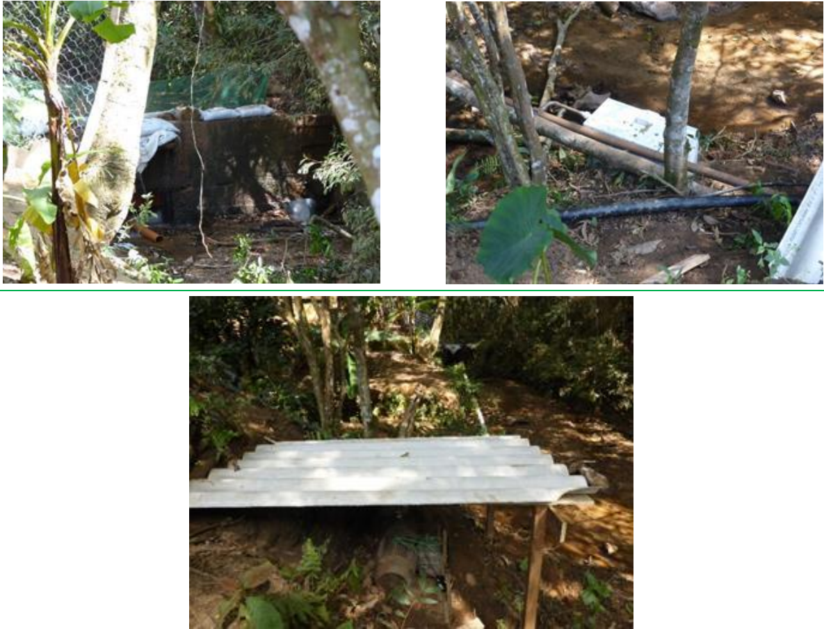
Figura 7.11 – Barramento em concreto alteado, clorador e tubulação adutora de água tratada (apenas clorada) e bomba de adução e injeção de água na rede de distribuição, respectivamente.
