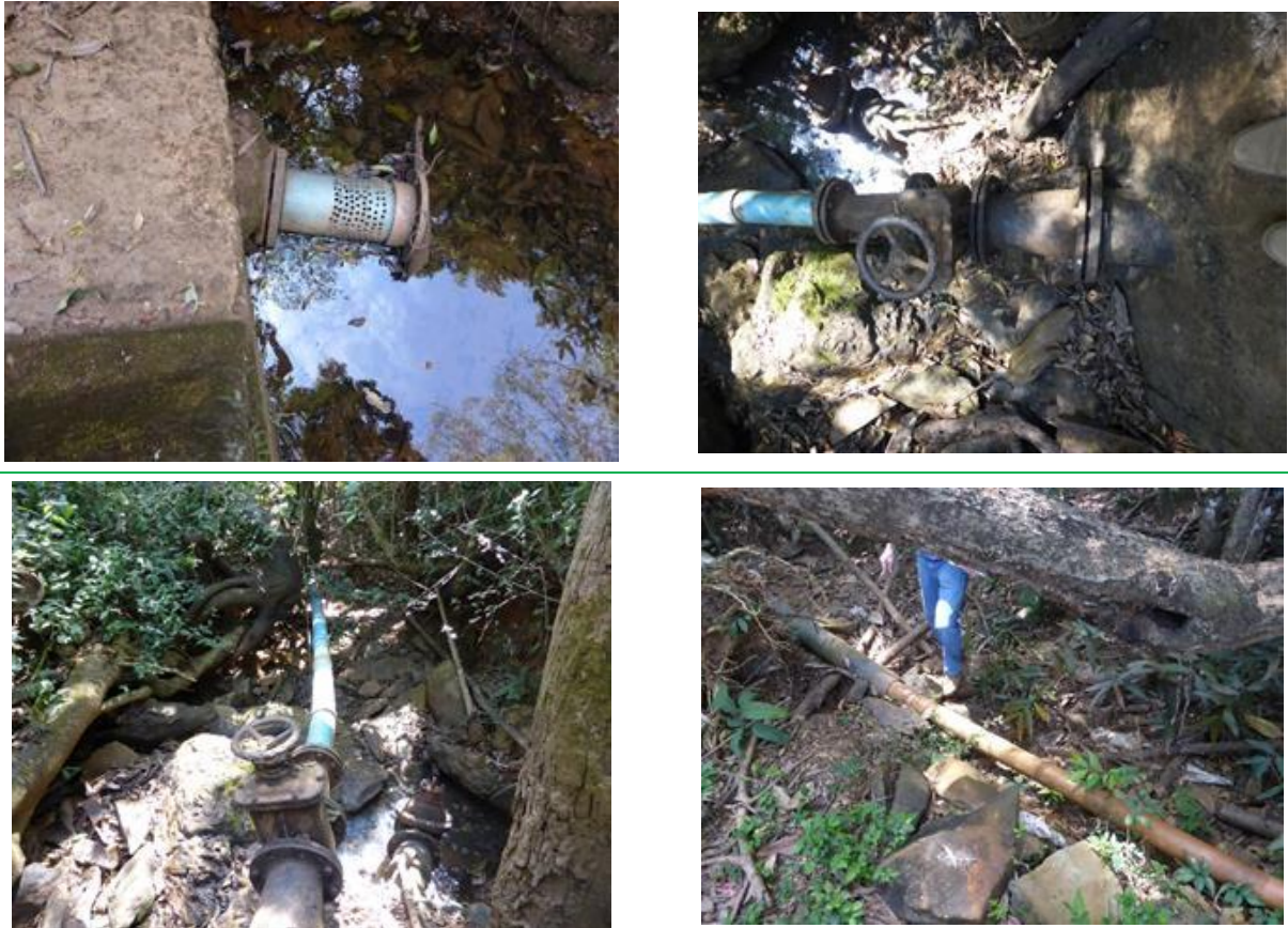
Figura 7.10 – Tomada d’água com crivo precário, adutora com reduções e registros, adutora em PVC 150 mm e emendas e diferentes tubos na adutora de água bruta, respectivamente.
